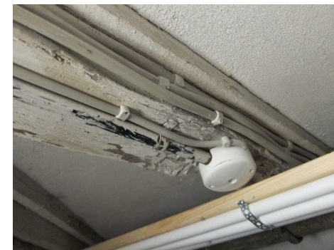
Ny og gammel installation i kælder
