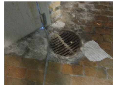
Gulvafløb i kælder
