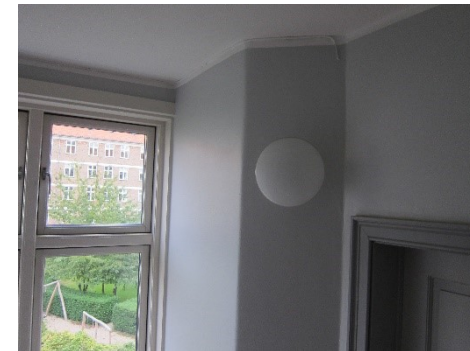
Ny trappelysinstallation på køkken-trappe
