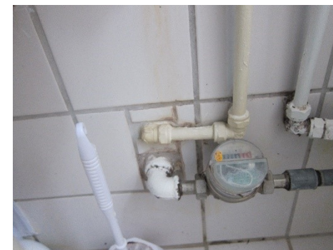
Vandinstallation i badeværelse
