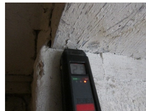
Fugtmåling i vinduesoverligger 29 %
