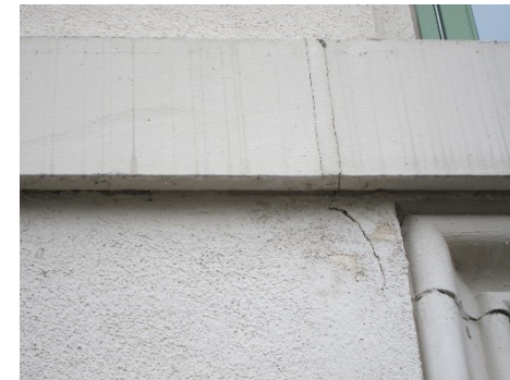
Revne ved hovedtrappe
