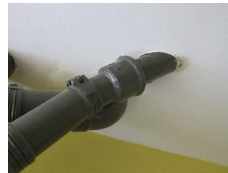
Gammelt rør i etageadskillelse
