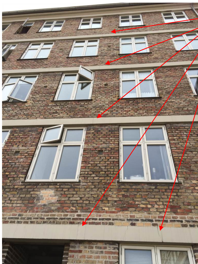
Facadebånd fremstår med mange svind revner.
