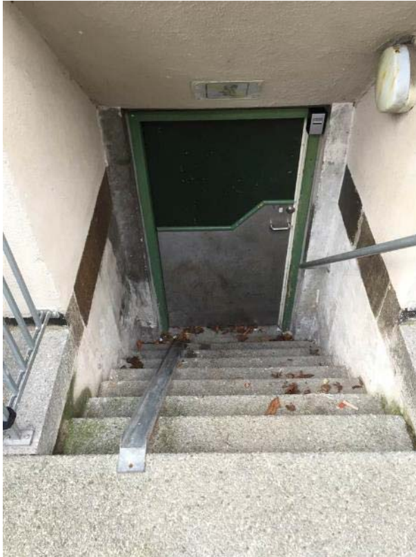
Kælderdøre fremstår slidt. Trænger til malerbehandling.
