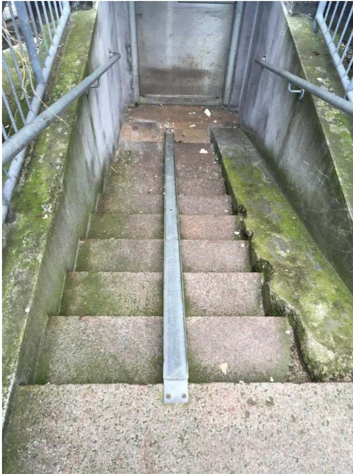
Kældernedgang med flere skader på betonen.
