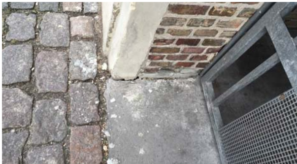
Mindre skader ved port.
