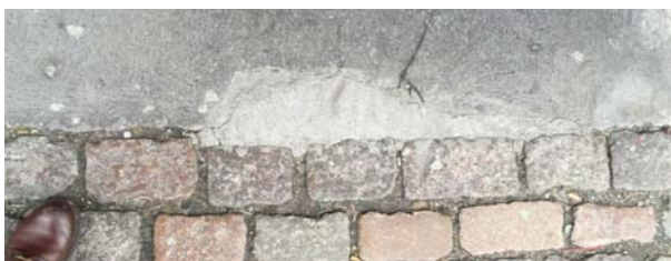
Mindre skader ved port.
