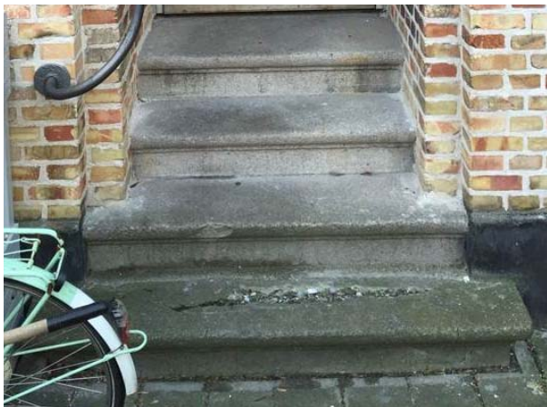
Gård trapper til bagdøre har flere betonskader på trin.
