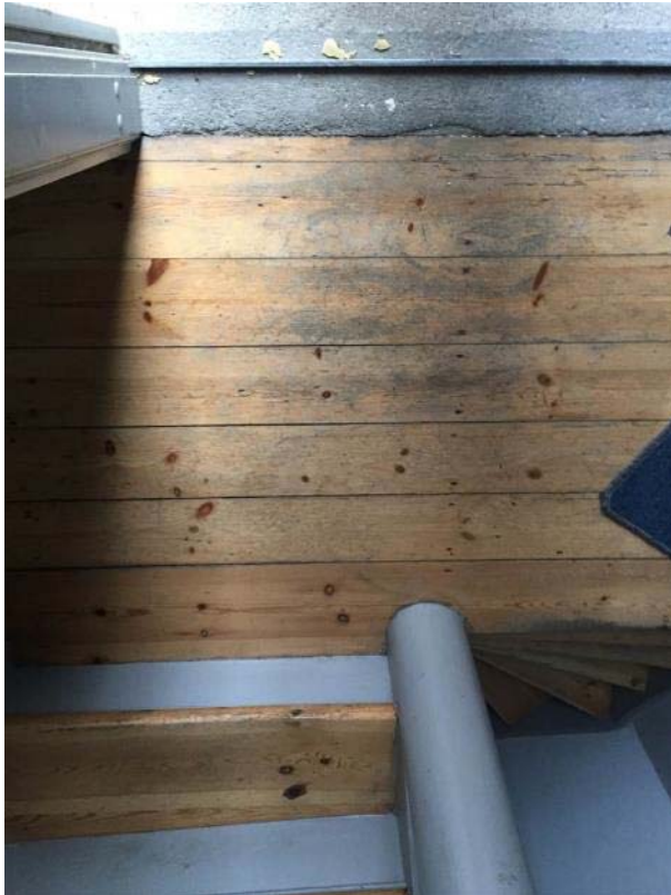
Bagtrapper meget slidt i lakken. Trappetrin er lakeret træ.
